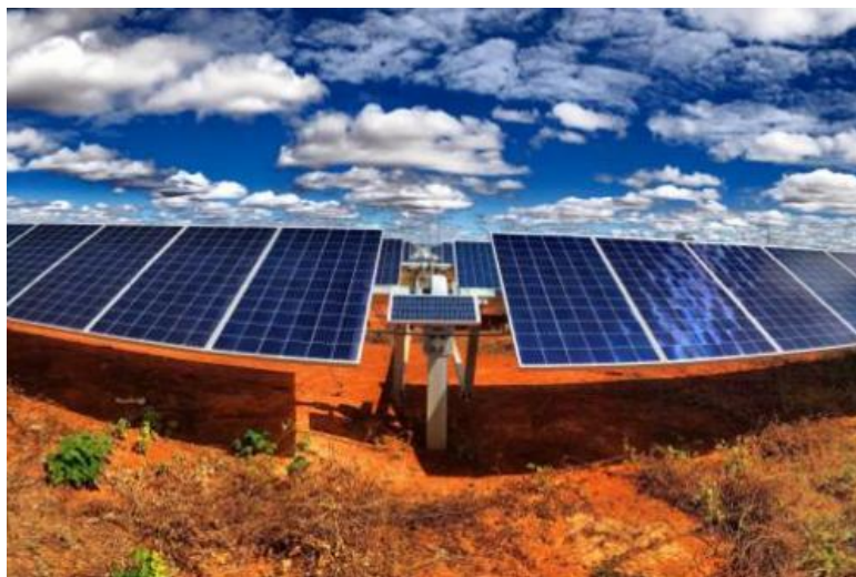
Ilustración 18. Seguidor solar a 1 eje N-S. Configuración 1V
