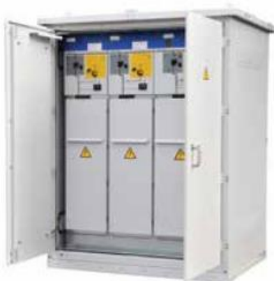
Ilustración 23. Centro de seccionamiento
